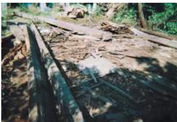
Talpa inferioară, complet putrezită, era așezată direct pe pământ. Datorită degradării, bârnele nu au mai fost utilizate și transportate spre noul amplasament
