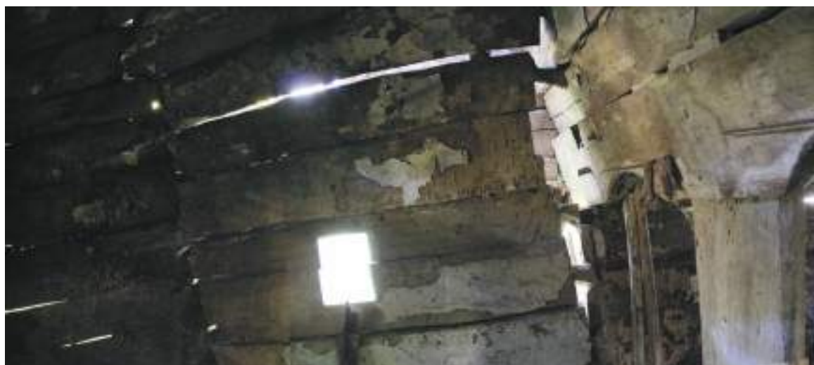
Îmbinare deteriorată în altar
