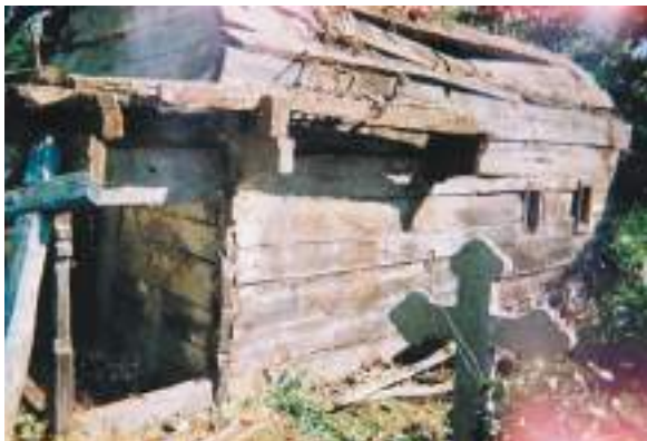
Pe partea sudică a boltei, bârnele erau degradate
