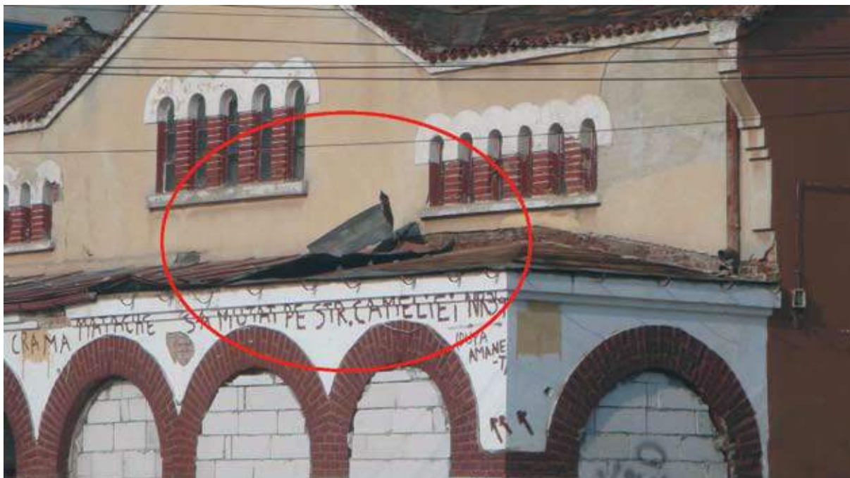
Vandalizare învelitoare Hala Matache, iunie 2011
