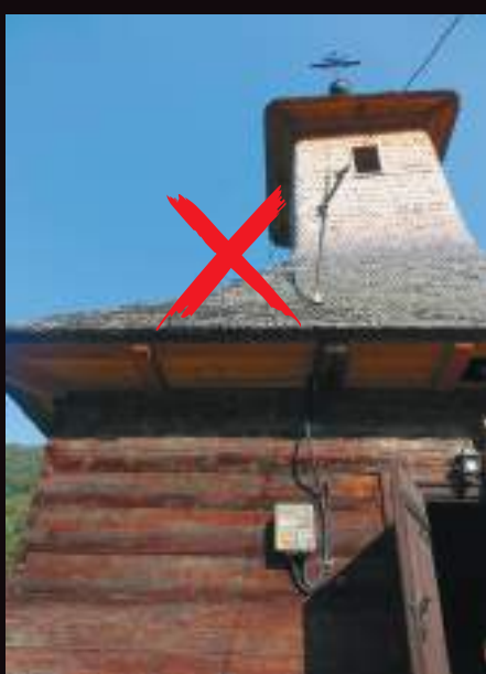
Exemplu de racord electric exterior, neprotejat antifoc.
