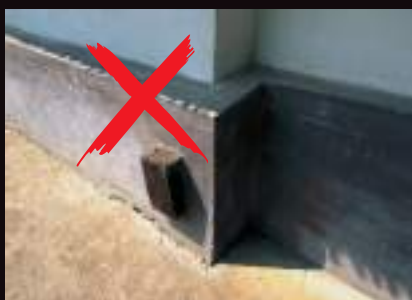
Socul a fost îmbrăcat în beton pe tot conturul bisericii și va deteriora lemnul.
