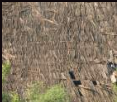
Învelitoare de șită degradată
