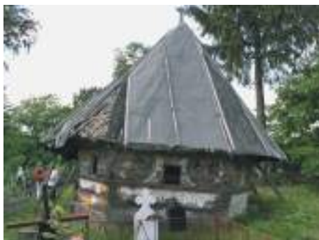
Biserica în 2009, înainte de prăbușirea boltii.
