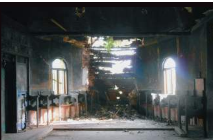
Degradare gravă a peretelui din bărne, cauzată de apa de ploaie infiltrată prin acoperișul deteriorat.
