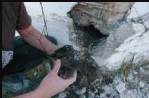
Așa arată lemnul care a fost îmbrăcat pe exterior cu ciment.
