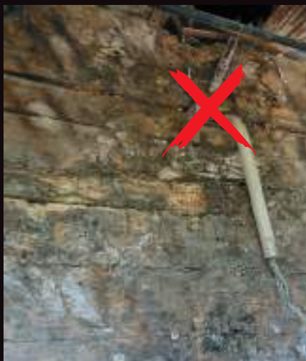
Exemple de instalații electrice improvizate care pot cauza daune și care afectează imaginea bisericii.
