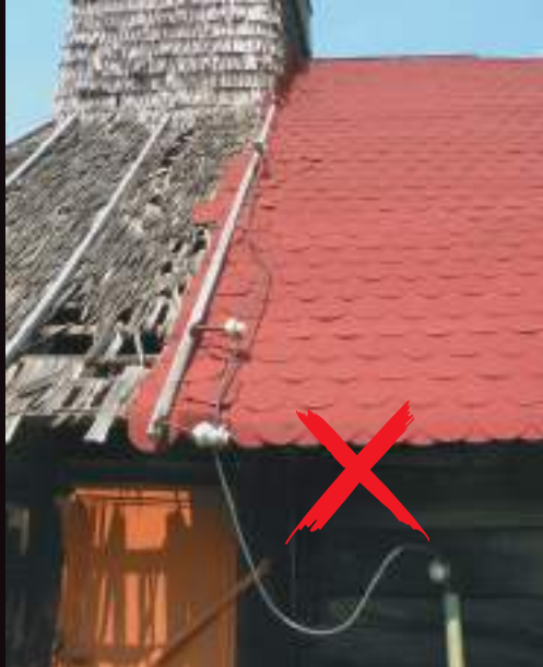
Exemplu de paratrăsnet montat pe învelitoarea în curs de înlocuire. Punctele de fixare sunt locuri unde șita se deteriorează mai rapid.
