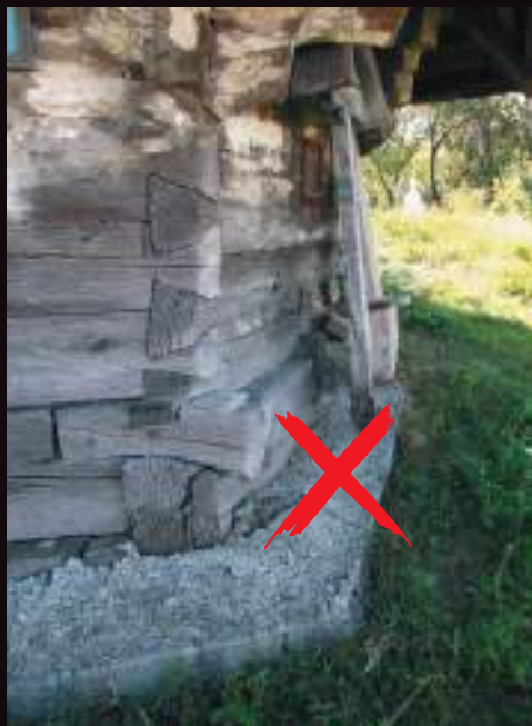
Împrejurul bisericii a fost turnat un strat de ciment care reține umiditatea, provocând prutrezirea tălpii de lemn.
