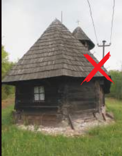
Exemplu comun de racord electric prin acoperiș, locul unde șita se deteriorează cel mai repede.
