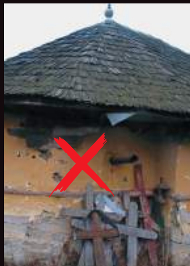
Coș impropriu de sobă care străpunge peretele.
